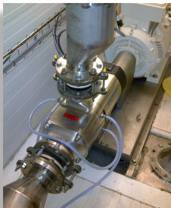
Een Hyghspin 125 verpompt sinaasappelconcentraat vanuit het laadruim naar de terminal
